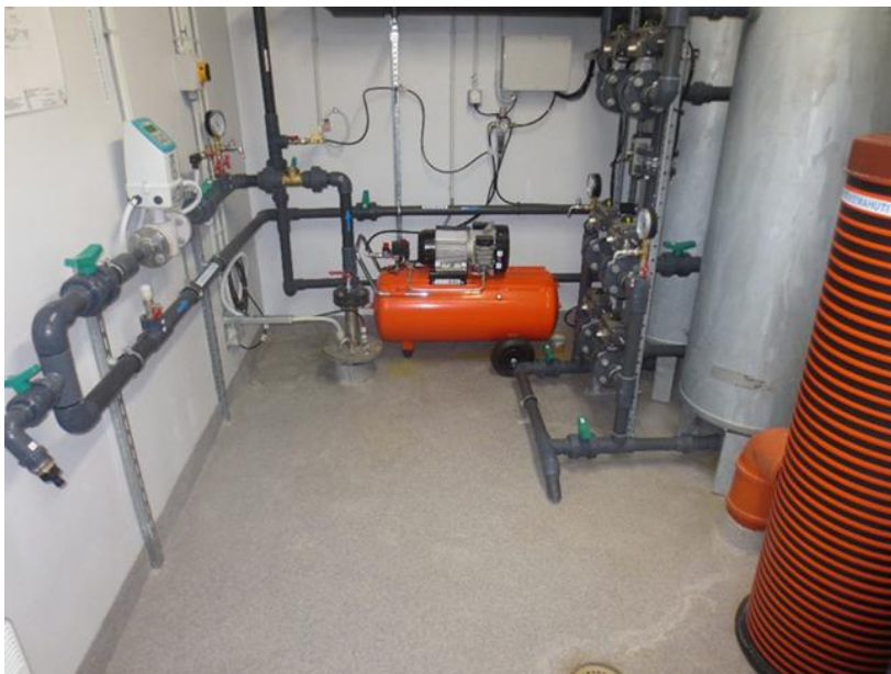
Joonis 4-8 Pumpla sisevaade, vasakul on-line vooluhulgamõõtja, järgneb puurkaevu päis, otse ees kompressor, veetötlusseadmed (tagumine eelaeratsioonipaak, esiplaanil survefilter) ning paremal uhteveemahuti
