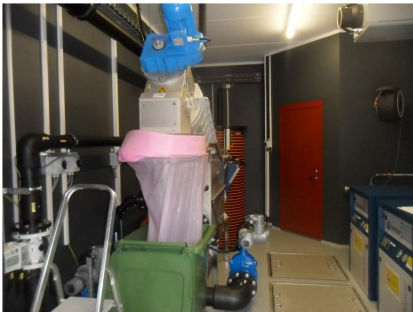
Joonis 5-18 Reoveepuhasti sisevaade, mehaaniline osa (automaatvõre) ning põranda all paiknevad protsessimahuti luugid
