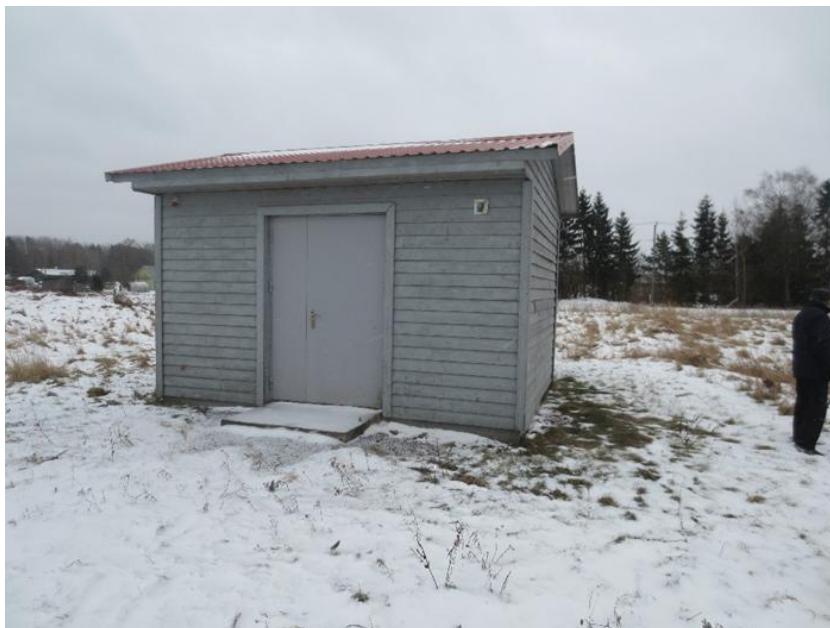
Joonis 4-14 Vaeküla Jaama puurkaevupumpla nr 25002 välisvaade
