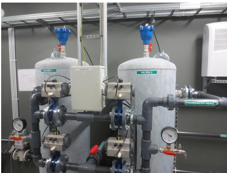
Joonis 4-11 Veltsi pumpla sisevaade, survefiltrid varustatud aeratsioonimikseriga
