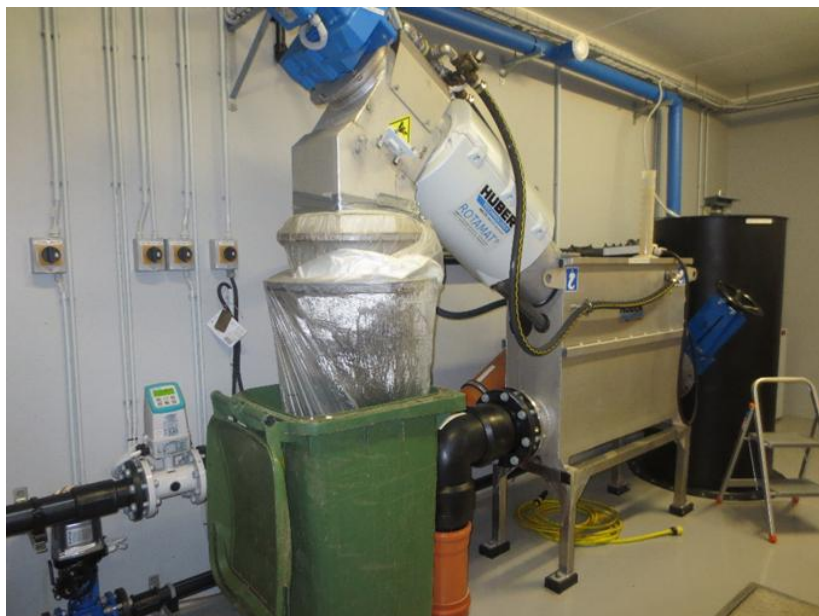
Joonis 5-4 Reoveepuhasti sisevaade (esiplaanil automaatvõreseade, tagapool vastuvõtumahuti)
