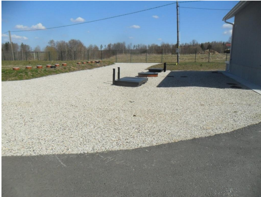
Joonis 5-21 Esiplaanil reovee peapumpla, järgneb järelpuhastusfilter ja heitveepumpla. Vasakul näha osa imbväljakust
