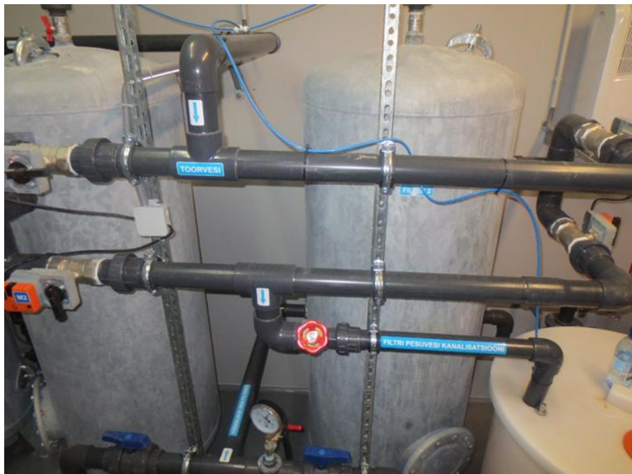
Joonis 4-4 Lepna puurkaevpumpila paarissurvefiltrid
