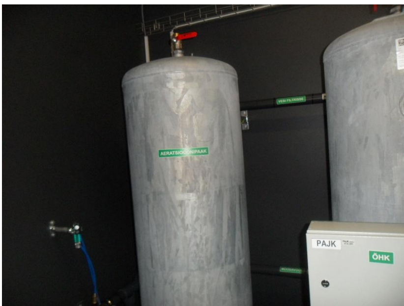
Joonis 4-18 Kohala puurkaevpumpla sisevaade, aeratsioonipaak
